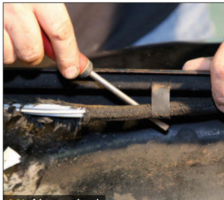
30 Le faisceau ne risquait pas de bouger.
