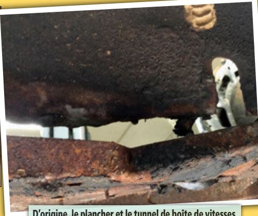
D'origine, le plancher et le tunnel de boîte de vitesses sont solidaires. La rouille a largement fait son œuvre.
